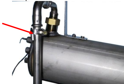
Temperaturfühler am Durchlauferhitzer:
