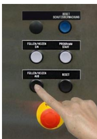
FÜLLEN / HEIZEN AUS
